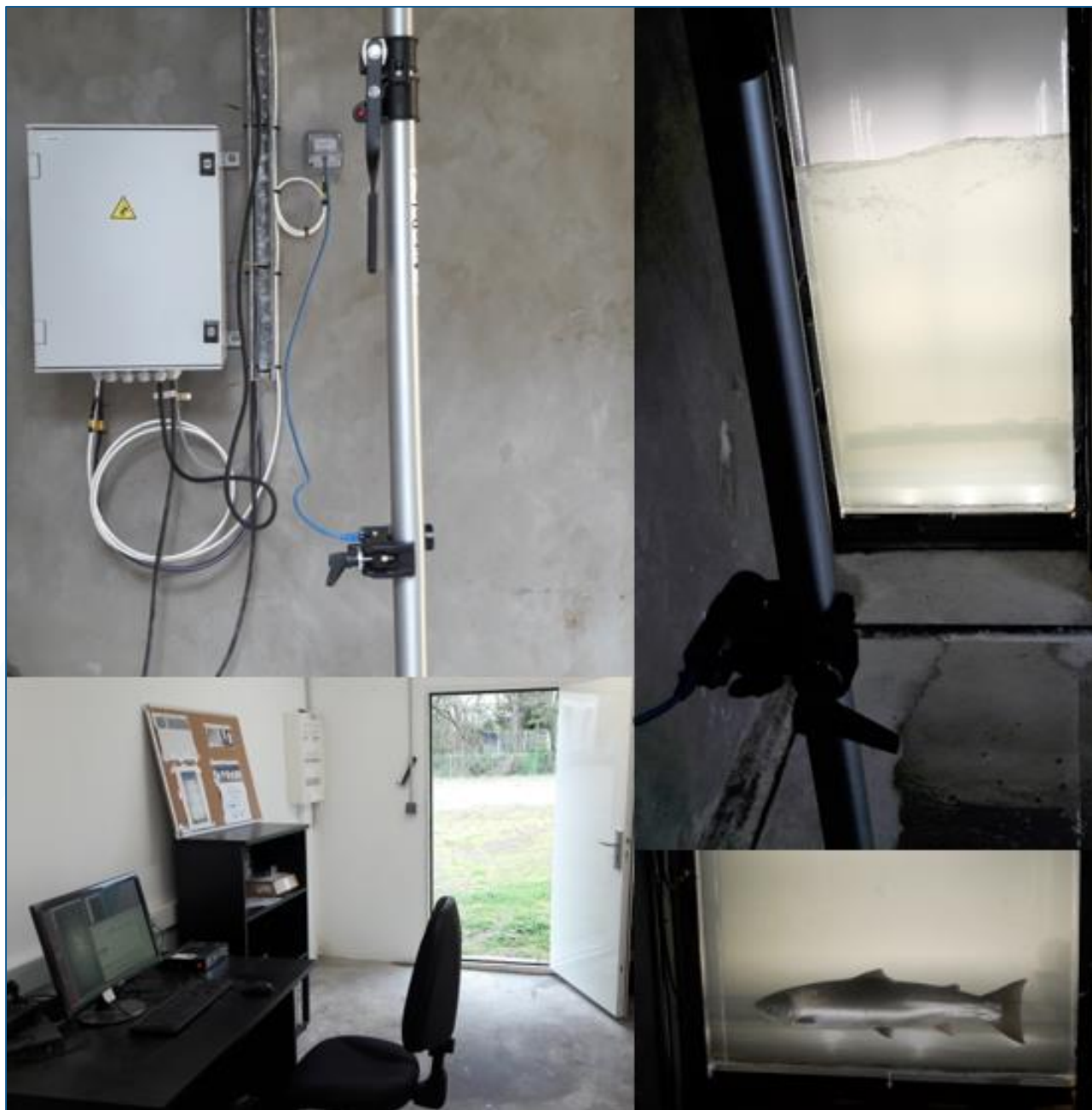
Figure 8 : Vues du dispositif de contrôle vidéo de Castetarbe
