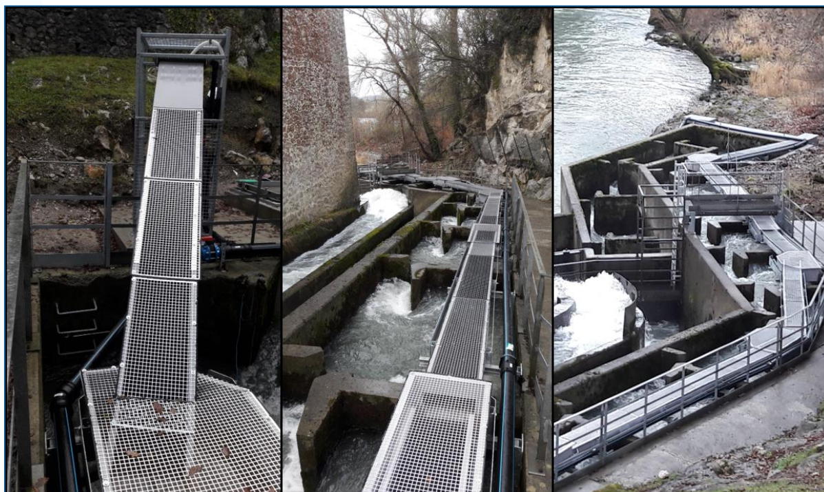
Figure 4 : Vues de l'amont vers l'aval de la rampe spécifique à anguilles du barrage de Castetarbe
