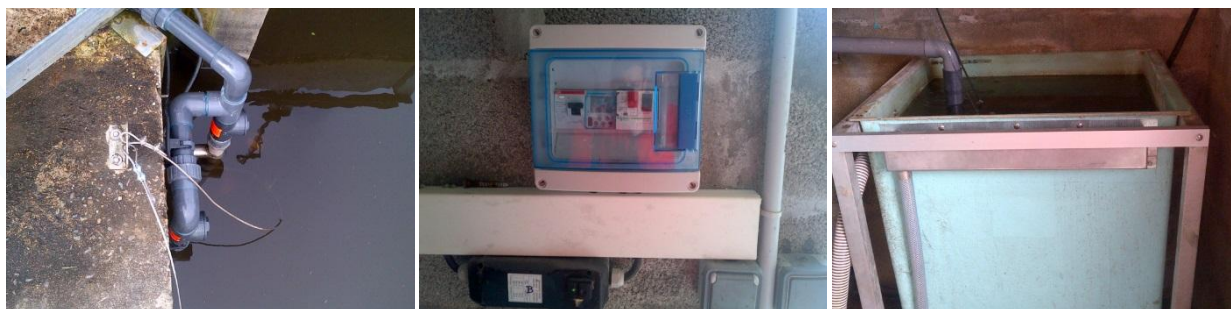
Figure 55 : Vues des 2 pompes d'alimentation, du tableau électrique et du système de "trop-plein"
