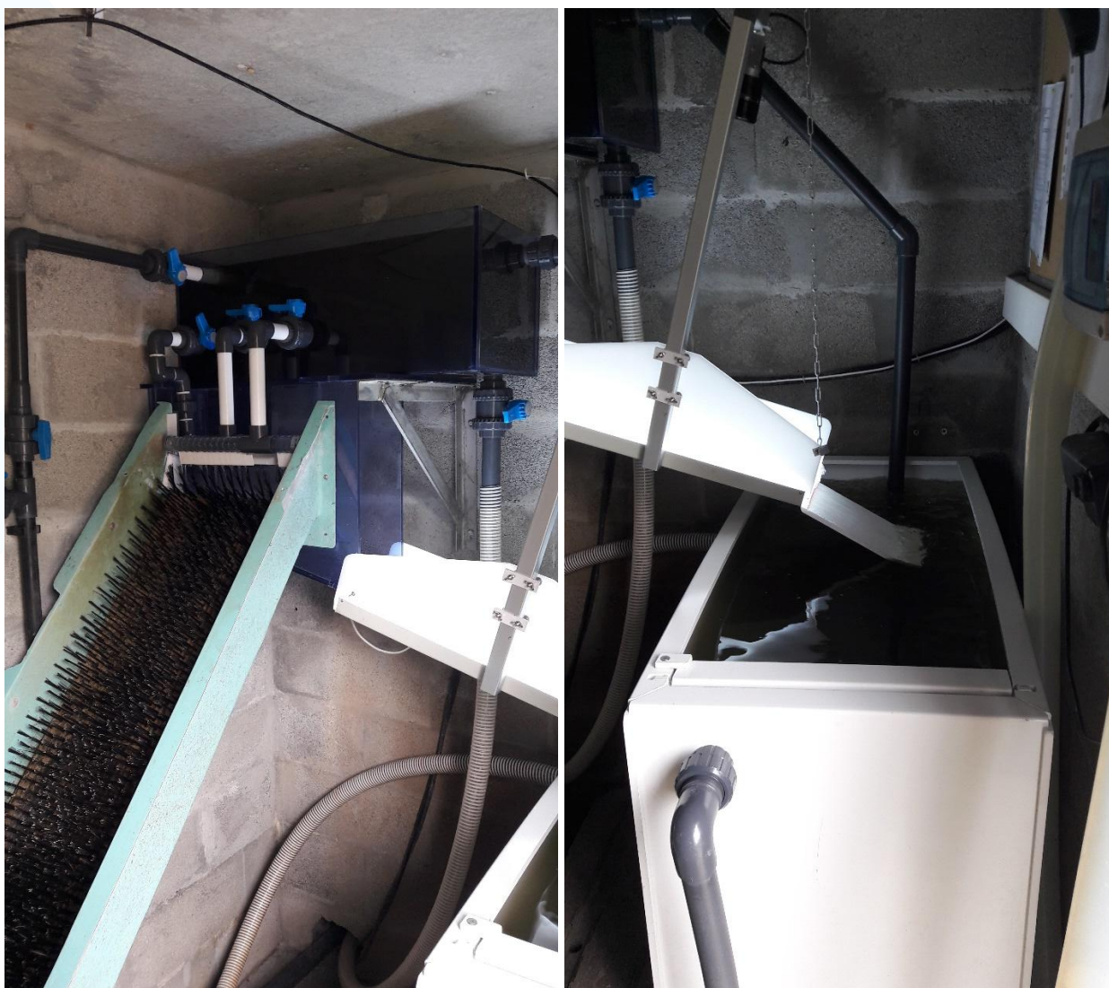
Figure 56 : Vues du nouveau système de mise en charge et répartition des flux d'eau et de poissons en Juin 2020
