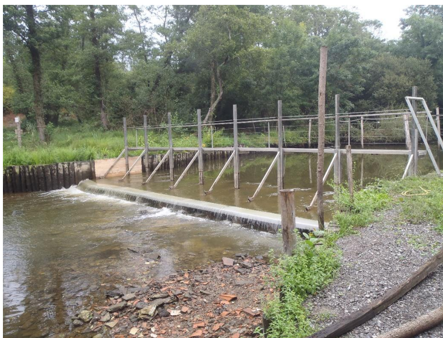
Figure 79 : Vue de l'habillage "extérieur" des berlinoises et du "tapis anti-accroc" suite aux aménagements complémentaires de l'automne 2016
