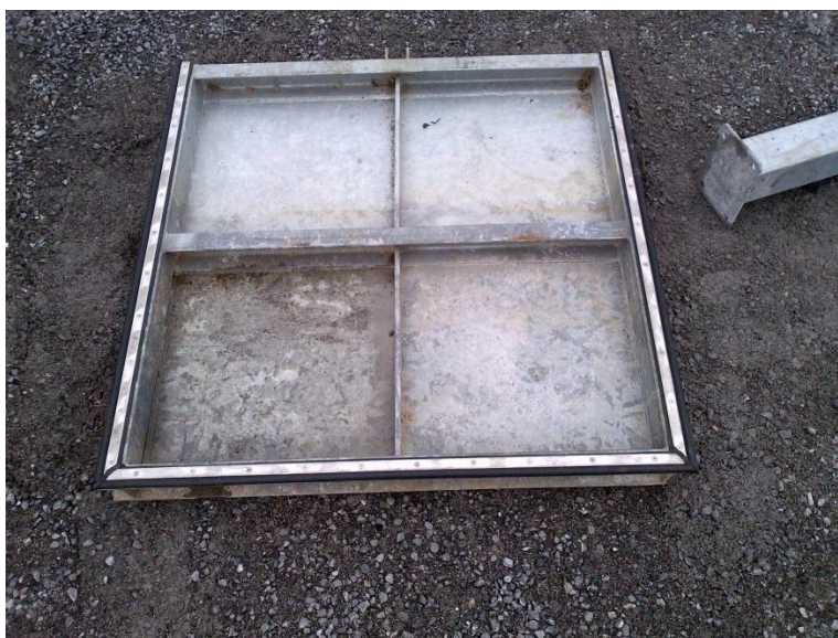
Figure 54 : Vue de la vanne amont de piégeage après pose d'un joint d'étanchéité
